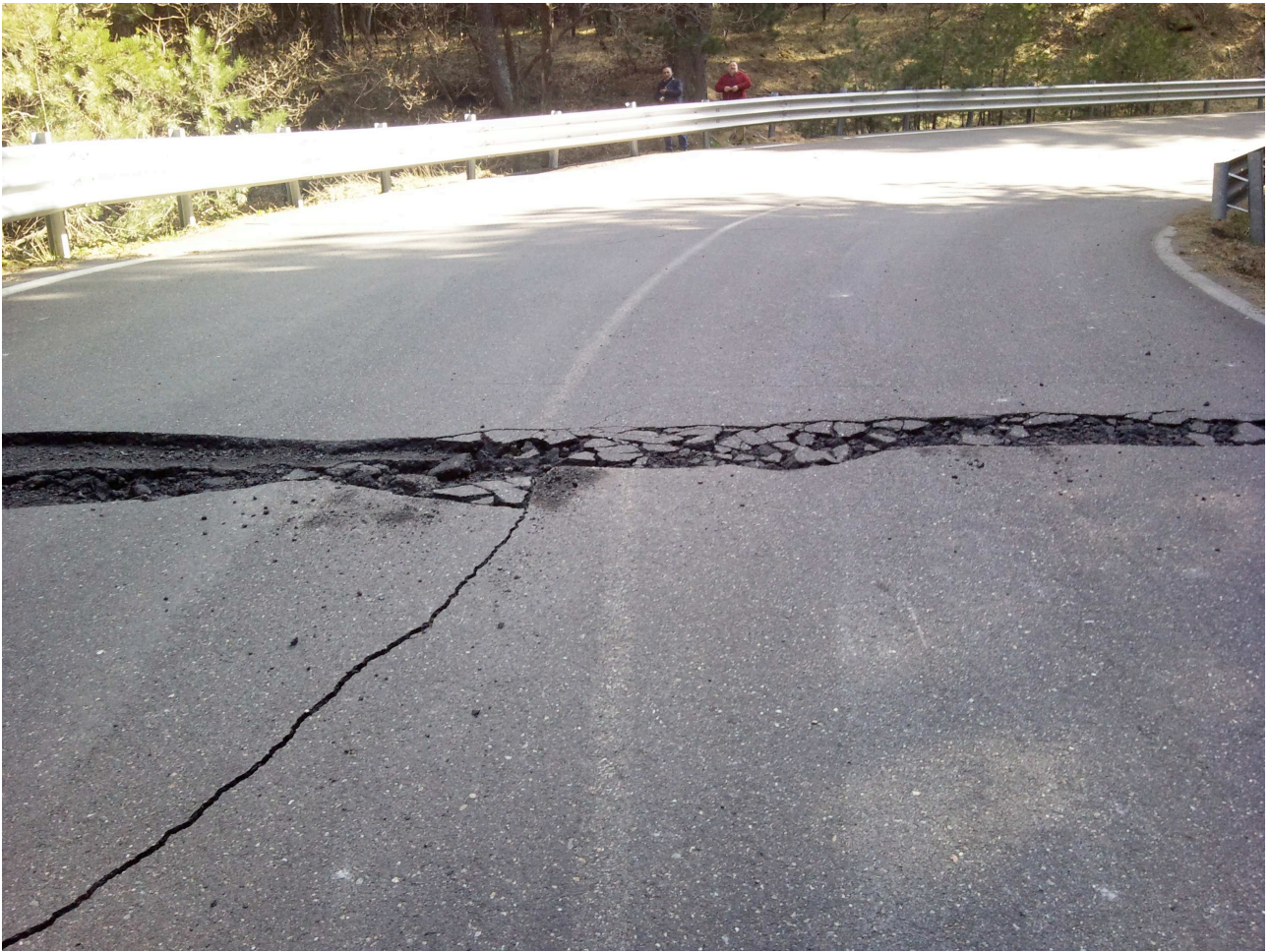
Faglia della Pernicana, Etna nel 2010. Si vede il movimento verso Est (verso sinistra nella foto) marcato dalla dislocazione della segnaletica orizzontale.
